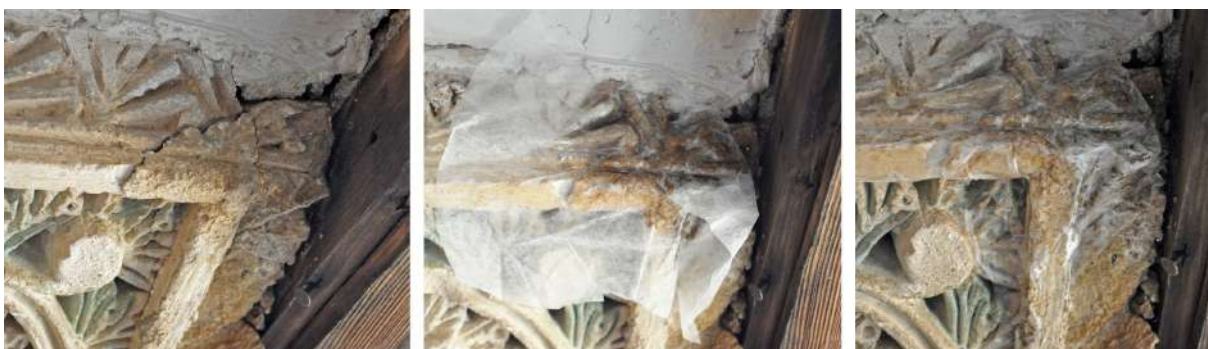
Figura 21. Zonas con riesgo de caída (izquierda), actuación (centro) y zona consolidada (derecha). Fotografía Museo Sefardí.
