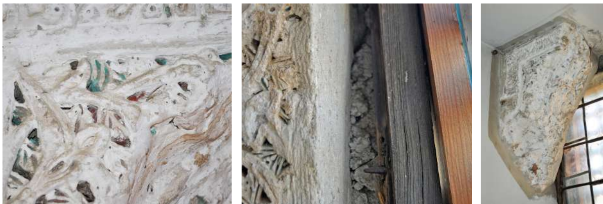
Figura 17. Detalle de policromía con la pintura blanca, detalle de la cara trasera y vista general de la ménsula. Fotografía Museo Sefardí.
