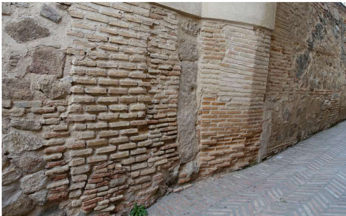
Figura 43. Faja de ladrillo (UE1062), piezas de granito (UE1065) y fábrica de ladrillo en chaflán (UE1066) de la Etapa I; faja de ladrillo de grandes dimensiones (UE1063, primer plano) añadida en la Etapa III. Reforma del chaflán (UE1067) en Etapa IVc
