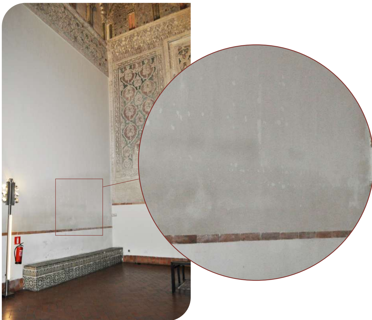
Figura 22: Detalle de las humedades detectadas. Fotografía Museo Sefardí.
